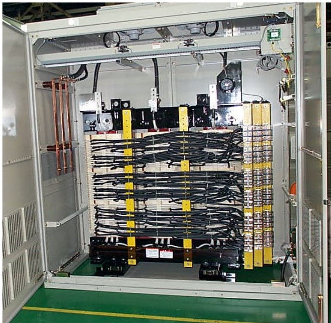
Входной трансформатор специальной конструкции (многообмоточный, сухого типа)
